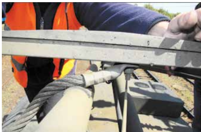
Fot. 5. Niewłaściwie zabudowany, elastyczny łącznik bocznikujący
