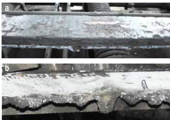
Fot. 7. Uszkodzenia węglowych nakładek stykowych spowodowane wydzielaniem się ciepła w czasie powstania łuku elektrycznego
