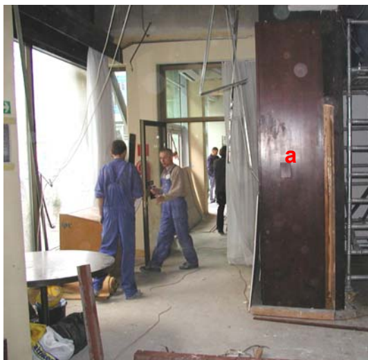
Fot. 2. Prace remontowe nie zostały poprzedzone usunięciem azbestu – na pierwszym planie widoczny materiał z azbestem nie przykryty folią (oznaczony jako „a”)
