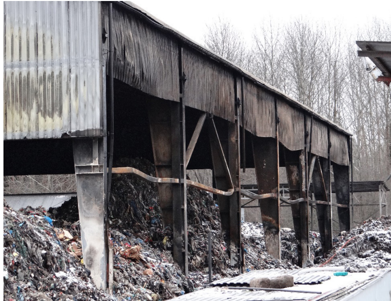
Ryc. 8. Widok hali 3 po pożarze Fig. 8. A view of hall 3 after the fire. Źródło: Opracowanie własne. Source: Own elaboration.
