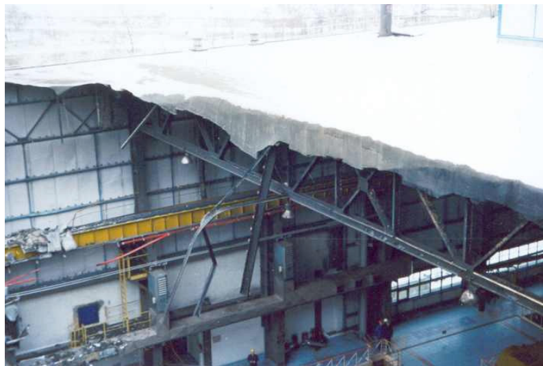
Ryc. 5. Zniszczony w pożarze dach maszynowni hali 2 pomiędzy osiami 7-10 [1]
