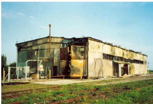
Ryc. 2. Widok hali 1 po ugaszonym pożarze [1]
