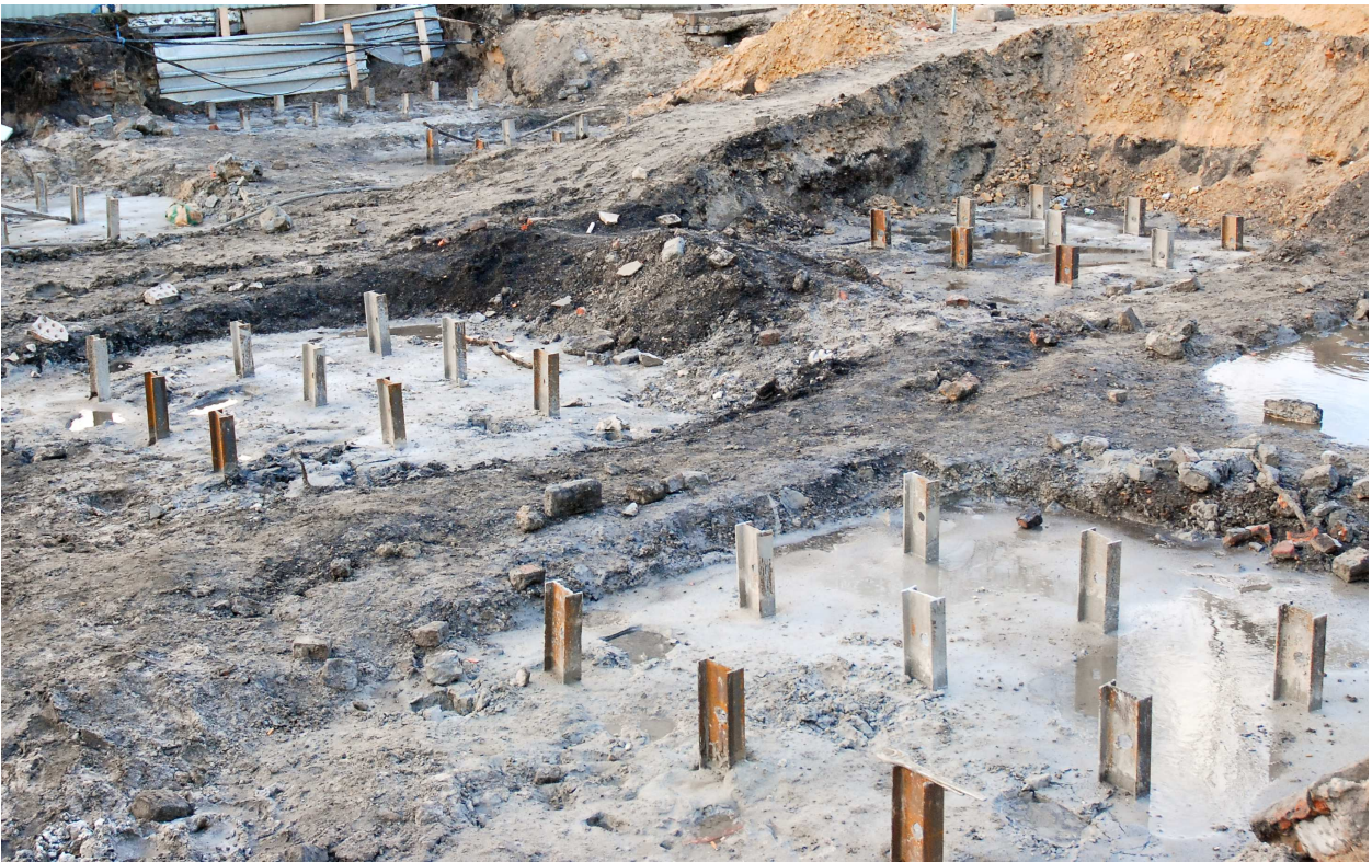
Rys. 7. Wykorzystanie zrzutów technologicznych jako wstępnej podbudowy pod warstwy konstrukcyjne przy rozbudowie siedziby oddziału ZUS w Sosnowcu (fot. własna)
