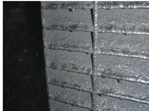
Fot. 5. Pył osiadły na kratkach żaluzjowych (Prostański 2012a)
