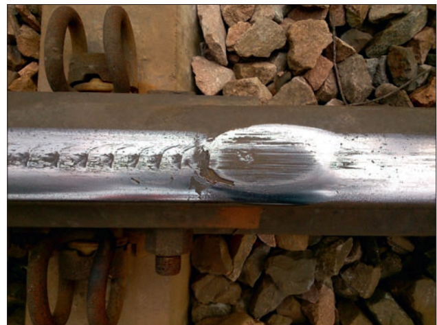
Rys. 2. Wybuksowanie, fot. Sylwester Żak Fig. 2. Wheel burn, photo Sylwester Żak
