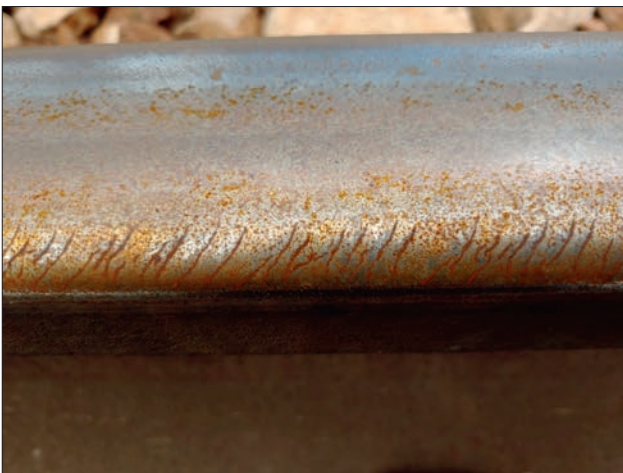
Rys. 1. Wada typu head checking, fot. Sylwester Żak Fig. 1. Head checking defect, photo Sylwester Żak
