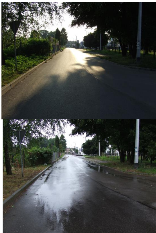
Rys. 6. Stan nawierzchni drogi
