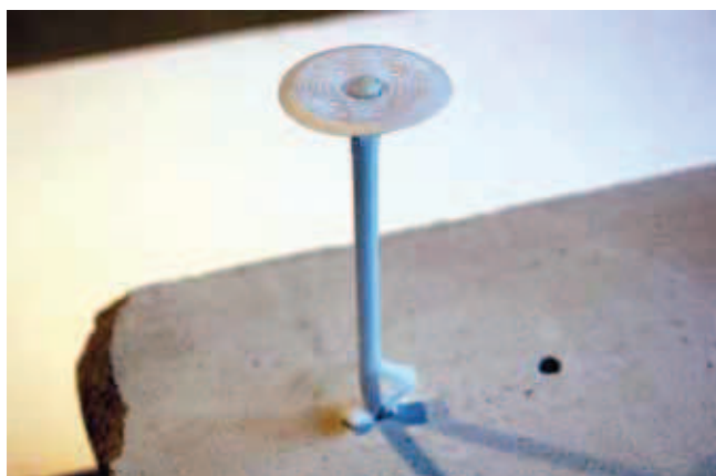
Rys. 11. Zniszczone łączniki tworzywowo-metalowe do mocowania termoizolacji osadzone w zbyt płytko wykonanym otworze lub w otworze o zbyt małej średnicy
