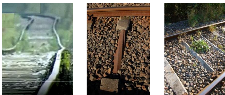
Rys. 1. Przykładowe deformacje nawierzchni kolejowej i jej elementów
