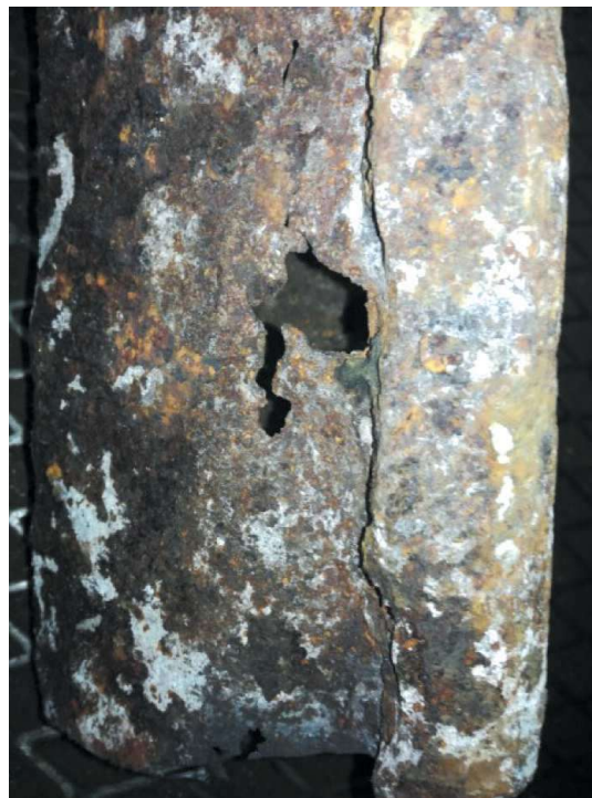
Rys. 2. Perforacja kształtownika w rejonie jego kołnierza
