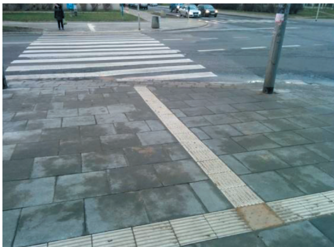
Fot. 1. Ścieżka prowadząca prowadzi bezpośrednio na ulicę – oznakowanie przejścia dla pieszych niezgodnie z wytycznymi
