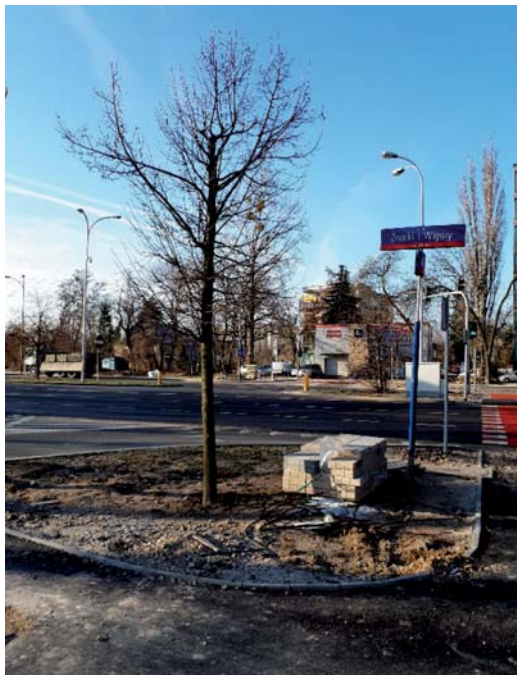
Fot. 4. Składowanie materiałów budowlanych w strefie korzeniowej drzewa. Autor: Karolina Góźdz, styczeń 2018
