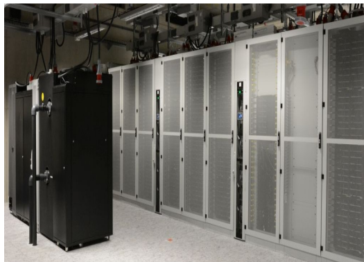
Rys. 4. Superkomputer „Orzeł”, zlokalizowany w PCSS w Poznaniu, z którego uzyskiwana nadwyżka ciepła przekazywana jest do ogrzewania budynku, na podstawie [8]
