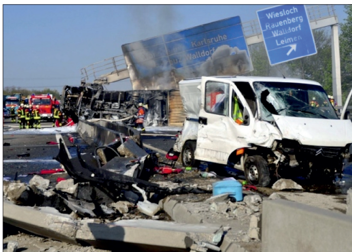
Fot. 1. Skutki zawalenia się bramownicy drogowej (źródło: Internet)
