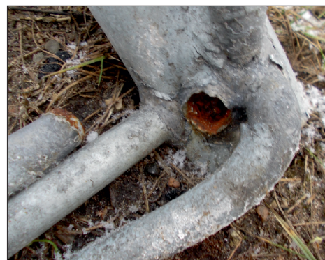
Fot. 5. Brak przetopu spoin stężeń (przeklejenia) (fot. Krzysztof Konecki)
