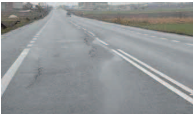
Rys. 6. Spękania i sfalowania nawierzchni – przypadek B (fot. Chlipalski K.)
