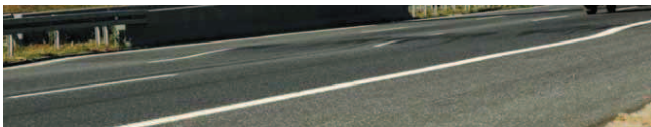
Rys. 1. Deformacja nawierzchni w obszarze uskoku (fot. Grygierek M.)
