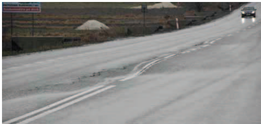
Rys. 7. Sfalowania, lokalne zagłębienia nawierzchni (fot. Chlipalski K.)
