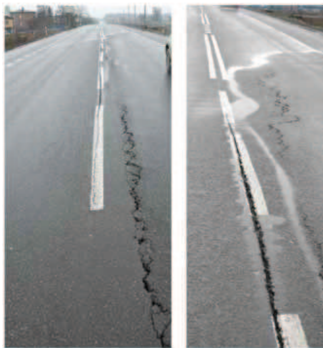
Rys. 8. Spękania, rozwarstwienie szwu technologicznego (fot. Chlipalski K.)
