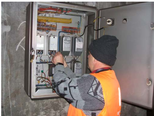
Rys. 2. Widok szafki pomiarowej 2A10 podczas prac kontrolnych przetworników pomiarowych typu PU51; w tej szafce tylko rejestracja wielkości TC realizowana jest przetwornikiem PU70
