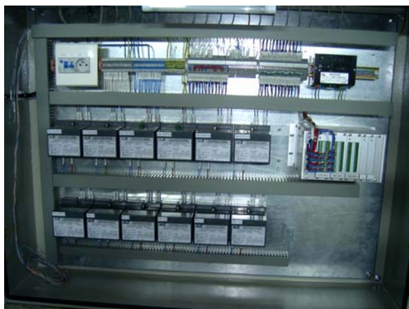
Rys. 3. Widok na szafkę pomiarową 1A19 systemu MPB przed doprowadzeniem sygnałów pomiarowych do dwunastu przetworników PU70; z prawej strony kasetka kart przetworników AC/DC i transmisji łącza RS, a nad nią zasilacz elektroniczny
