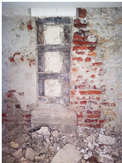
Rys. 12. Widok odsłoniętego wzmocnienia słupów w ścianie zewnętrznej po ponad 20 latach od jego realizacji
