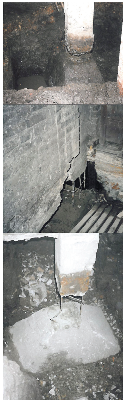
Rys. 9. Odkrytki fundamentów pod słupami w ścianie zewnętrznej i słupami wewnętrznymi [5]. Widoczna woda gruntowa w wykopie, zdegradowane fragmenty słupów, a także wygięte wskutek wybożenia pręty zbrojeniowe
