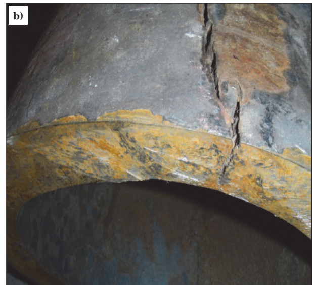
Rys. 4. a) pęknięcie zlokalizowane na rurociągu, b) fragment materiału pobranego do badań
