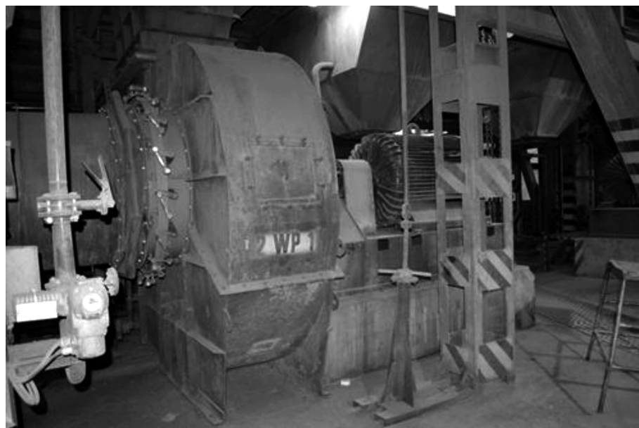
Rys. 2. Wentylator powietrza świeżego – obiekt poddany analizie FMEA
