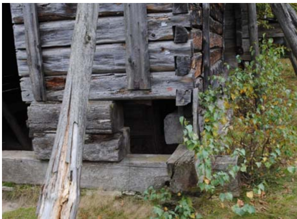
Ryc. 3. Fragment naroża ściany od strony południowo-zachodniej przedstawiający bardzo duże zniszczenie w narożu, 2013, fot. Ł. Gołda Fig. 3. Fragment of a wall corner on the south-west side showing very large damage in the corner, 2013, photo by Ł. Gołda
