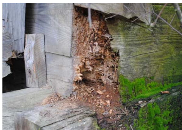
Ryc. 5. Fragment naroża nawy, zbutwienie całego narożnika (węglowania) belki zrębowej z podwalinową, 2013, fot. Ł. Gołda Fig. 5. Fragment of a corner in the nave, dry rot around the corner where framework beam meets the ground beam, 2013 photo by Ł. Gołda
