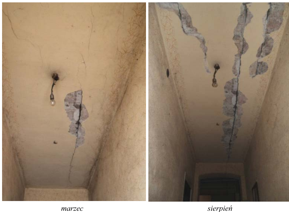
Fot. 1. Przykład zmiany stanu uszkodzenia stropu DMS w klatce schodowej budynku podlegającego oddziaływaniom górniczym (Florkowska i in. 2016) (fot. I. Bryt-Nitarska)
