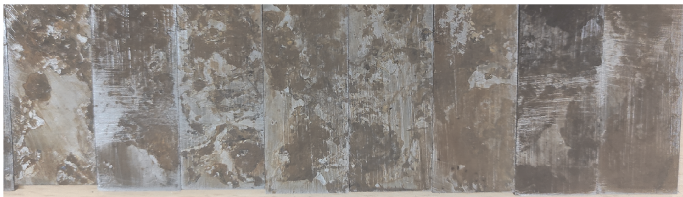
Rys. 5. Skorodowane próbki z widocznymi zarysowaniami po procesie oczyszczania
