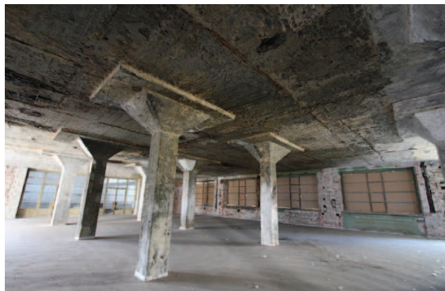
Rys. 4. Widok zaolejonego stropu nad I piętrzem
