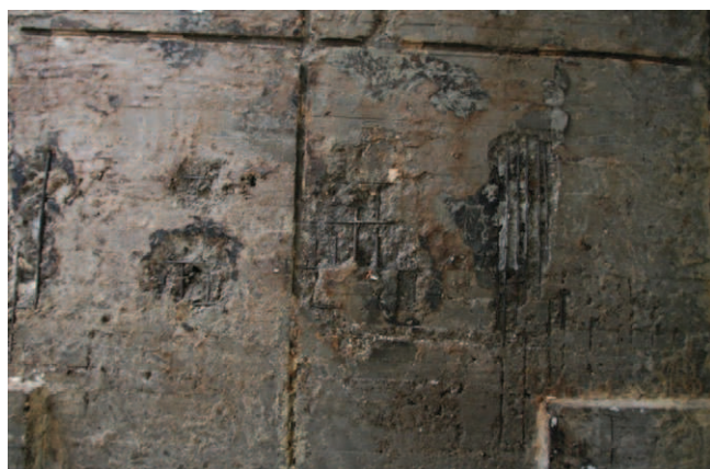
Rys. 5. Odkryte i skorodowane zbrojenie zaolejonego stropu
