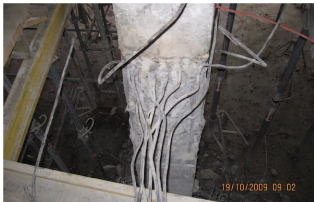
Rys. 15. Wyburzony obszar stropu wokół słupów żelbetonowych
