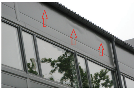
Fot. 3. Odspojenia okładzin od rdzenia płyt warstwowych
