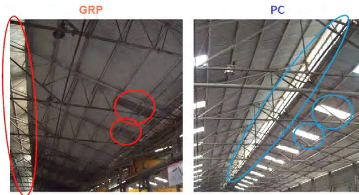
Rys. 1. Świetliki wykonane z poliestru wzmocnianego włóknem szklanym (GRP) po okresie użytkowania 5 lat (po lewej) i podobne świetliki wykonane z poliwęglanu (PC) po takim samym okresie użytkowania (po prawej) [6]
