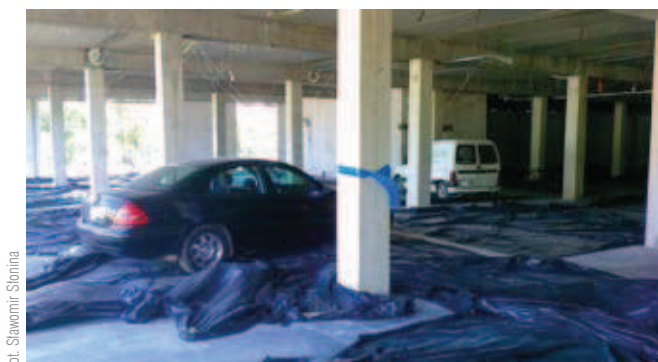
Fot. 2. Zbyt wczesne użytkowanie posadzki przemysłowej
