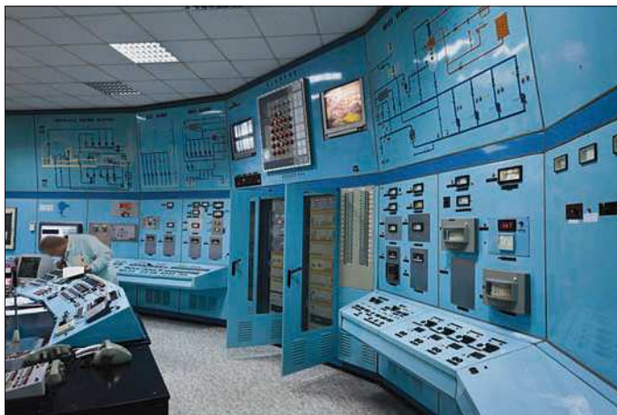
Fot. 4. Świerk – widok na pomieszczenie sterowni reaktora MARIA
