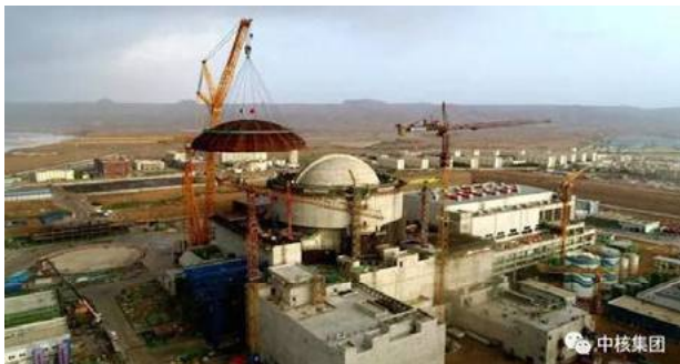
Fot. 4. EJ w Pakistanie. Nałożenie kopuły obudowy bezpieczeństwa (fot.GCR) Photo 4. China Tops out Hualong One nuclear plant in Pakistan (By GCR Staff)
