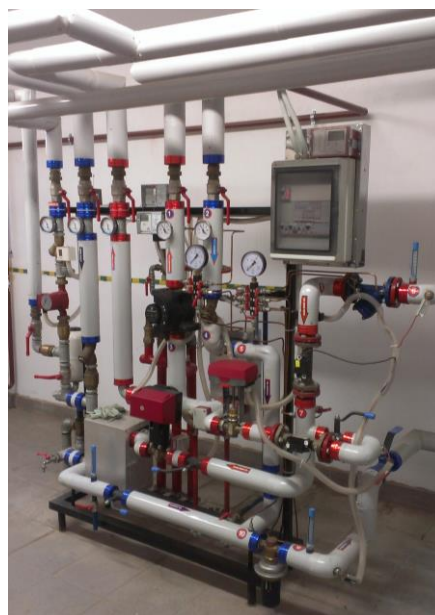
Rys. 3. Компактний вузол теплий Мал. 3. Компактні підстанції
