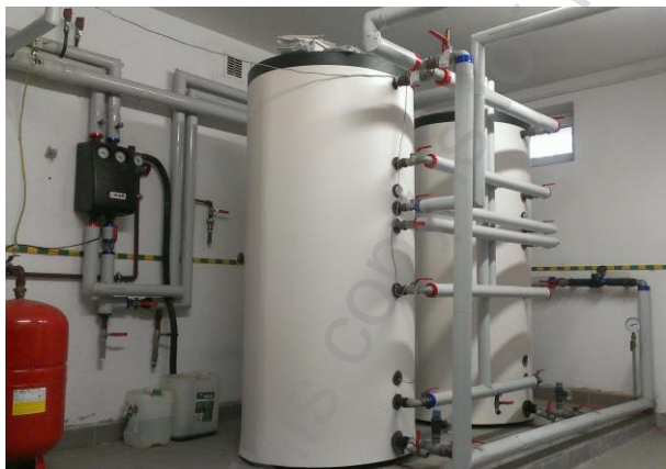
Rys. 2. Zbiorniki magazynujące instalacji słonecznej Мал. 2. Накопичувальні сонячні баки
