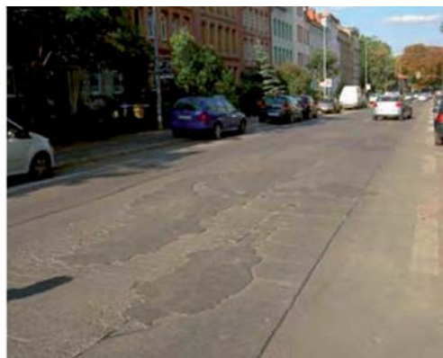
Rys. 14. Moritzwallstrasse – widok uszkodzeń istniejącej nawierzchni
