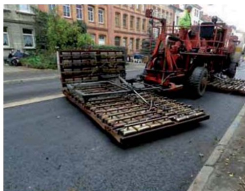
Rys. 18. Urządzenie do podgrzewania nawierzchni
