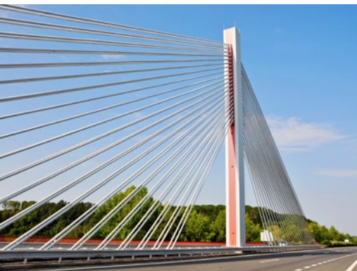
Zakotwienia want obiektu nr 56 w pylonie
