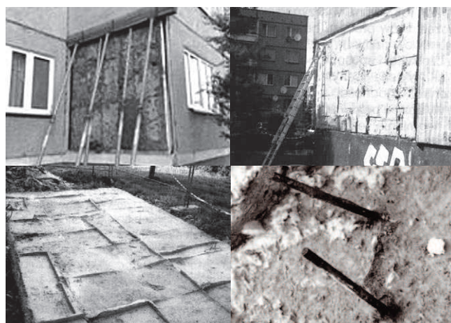
Rys. 15. Widok ścian szczytowych ZWS po oderwaniu się warstwy fakturowej: a) wg [24], b) wg [16], b2) widok wewnętrznej powierzchni oderwanej warstwy fakturowej po usunięciu izolacji z wełny mineralnej, b3) zerwane pręty wieszaka zakotwione w warstwie fakturowej
