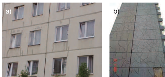
Rys. 10. Przykłady charakterystycznych zarysowań w warstwie fakturowej: a) ściany osłonowe ZWO, fot. Inwestbud b) ściany nośne ZWS, fot. http://www.goluszka.pl
