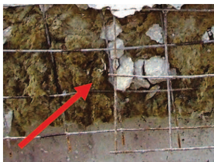
Rys. 14. Wadliwie zamontowana szpilka w płycie betonowa- nej fakturą do dołu [fot. Inwstbud]
