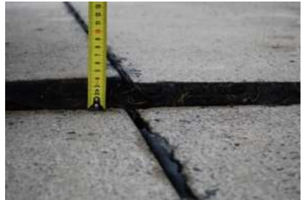
Rys. 5. Próg na połączeniu płyt betonowych
