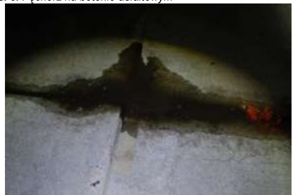
Rys. 7. Zastoisko wodne na nawierzchni betonowej
