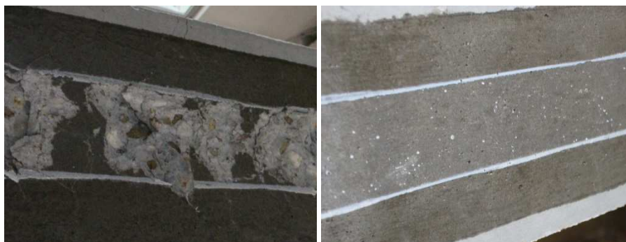
Rys. 2. Powierzchnia belki żelbetowej po delaminacji (a) belka CFRP_T56; (b) belka CFRP_T73
