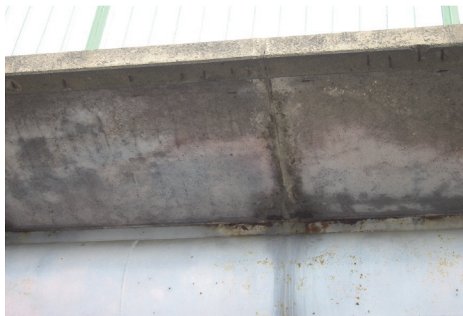
Rys. 4. Korozja powłoki konstrukcji przeseł. Bardzo wyraźne lokalne uszkodzenia w przekroju dylatacji płyt chodnikowych
