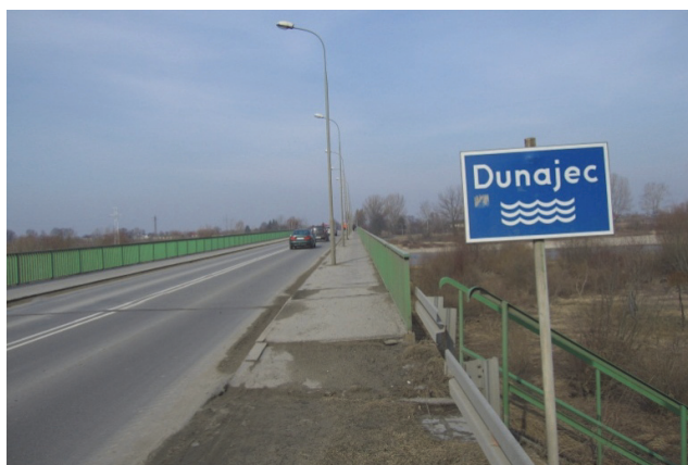
Rys. 3. Widok od strony Tarnowa na jezdnię mostu, na której widoczne są deformacje. W szczególności złym stanie jest nawierzchnia chodnika (chodników) na długości skrzydełek i dalej. Pomimo tego dylatacje zachowały szczelność
