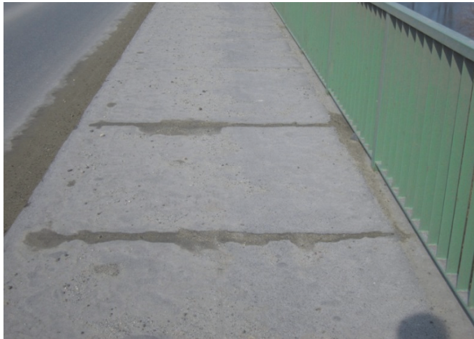
Rys. 6. Pęknięcia nawierzchni chodnika od dolnej wody w miejscach dylatacji płyt chodnikowych
