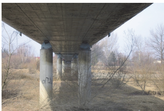
Rys. 2. Widok mostu od dołu. Stan blachy od spodu znacznie lepszy niż z boków. Potwierdza to szczególnie szkodliwy wpływ dylatacji płyt chodnikowych i perforacja w tych miejscach izolacji
