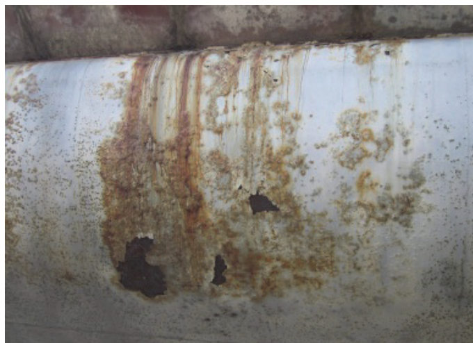
Rys. 7. Perforacja blachy opasującej dźwigary główne w miejscu przecieków
