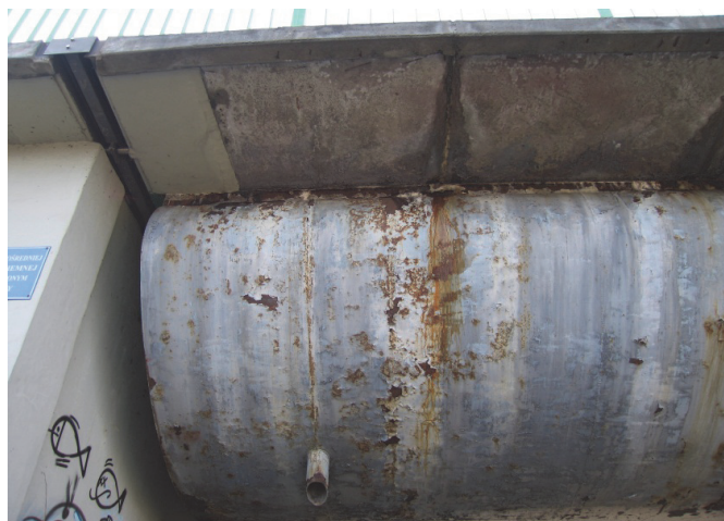
Rys. 5. Stan konstrukcji przy przyczółku prawobrzeżnym od strony dolnej wody. Potwierdza się szczelność dylatacji i miejsce przecieku wody
