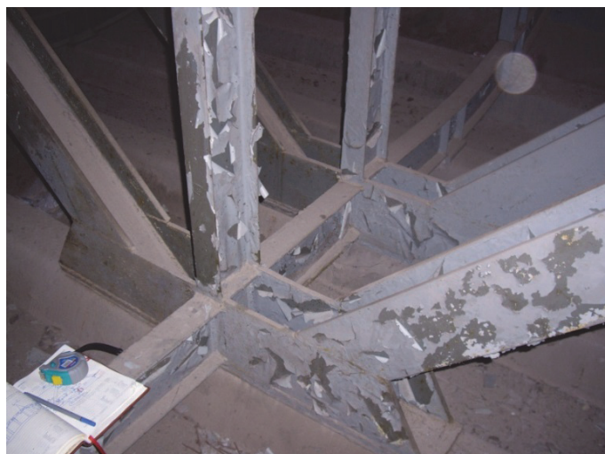
Rys. 11. Przykład innego węzła dolnego kratownicy. Widoczne pręty kratownic wykonane z dwuteowników walcowanych. Złuszczenie powłok malarskich, lecz bez wyraźnej korozji elementów stalowych
