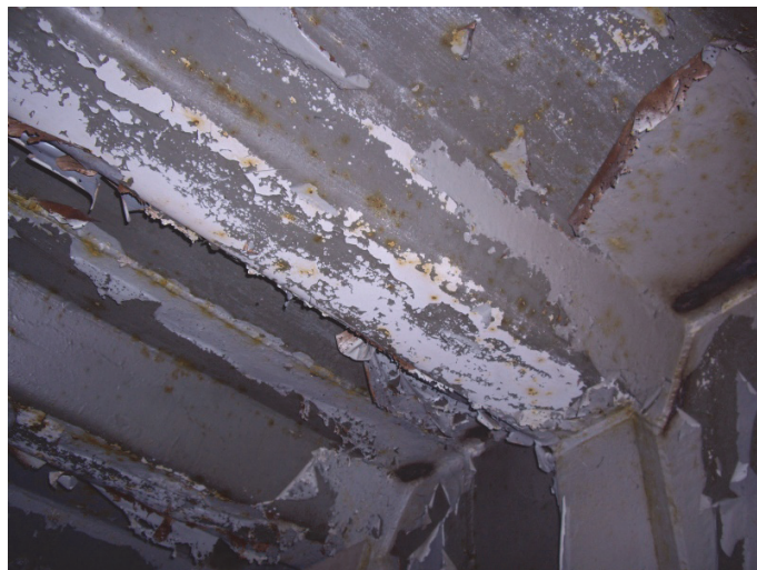
Rys. 10. Korozja powierzchniowa elementów wewnętrznych. Również w tym przypadku brak korozji elementów stalowych pod jezdnią. Pokazany stan jest najgorszy (dźwigary główne) w całym obiekcie
