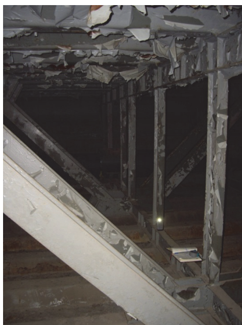
Rys. 9. Zniszczone powłoki malarskie wewnątrz konstrukcji mostu, lecz bez wżerów korozyjnych
