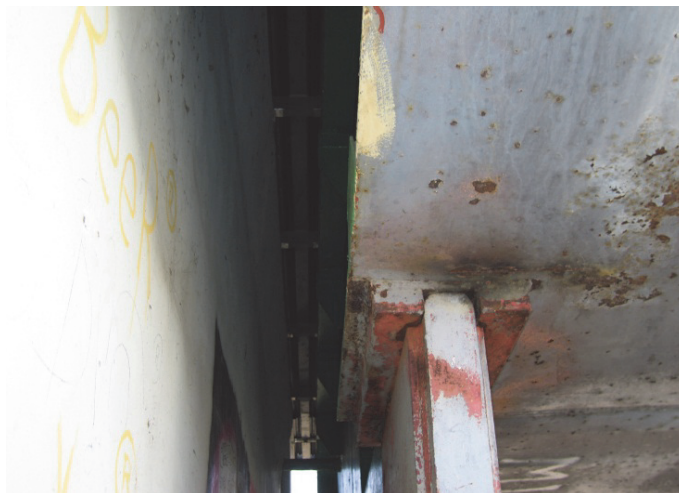
Rys. 8. Widok na dylatację przy przyczółku lewobrzeżnym od spodu konstrukcji. Widoczny dobry stan łożysk. Brak przecieków przez dylatację
