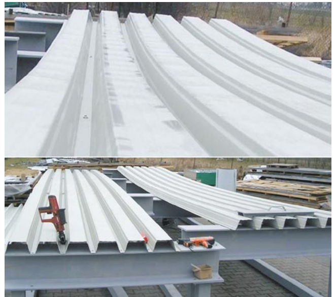
Rys. 20. Utrata stateczności ścianek blachy podczas próbnego montażu blachy z wygięciem wstępnym
