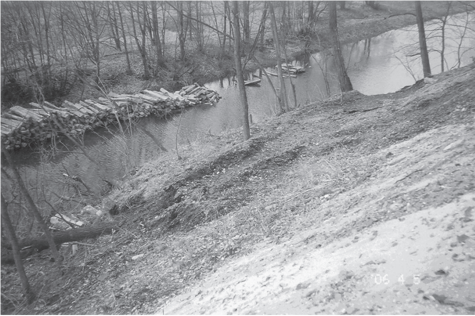
Rys. 4. Skarpa nasypu w stanie osuwiskowym {6}
