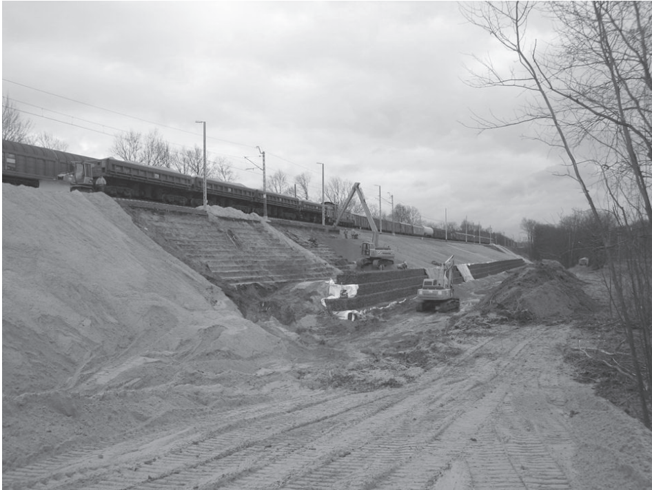
Rys. 7. Dokumentacja fotograficzna obudowy uszkodzonego nasypu {6}
