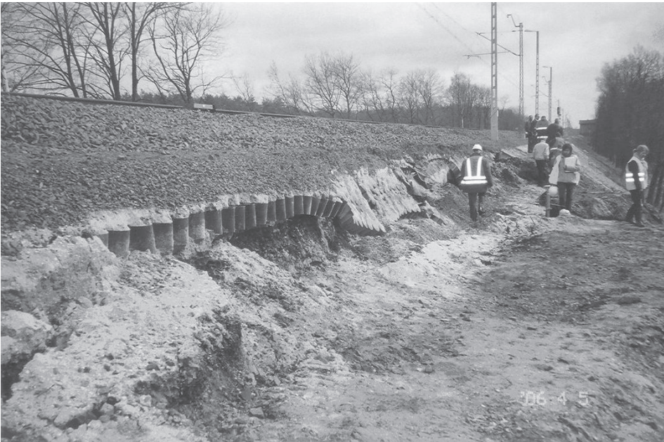
Rys. 5. Nasyp w stanie osuwiskowym {6}
