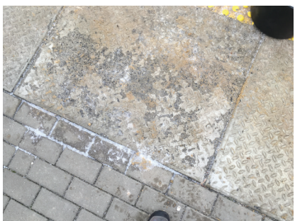
Fot. 7 i 8. Złuszczonej powierzchni płyty peronowej
