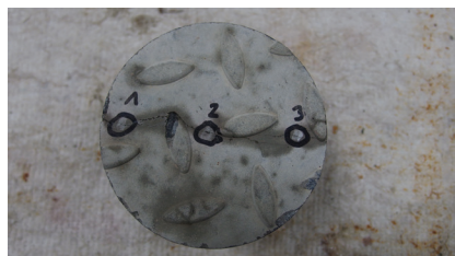
Fot. 10. Rozmieszczenie kruszywa w rozsegregowanym betonie w płycie peronowej (zjawisko segregacji i sedimentacji betonu)
