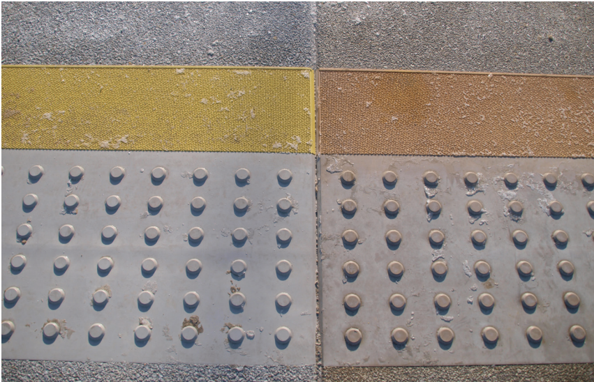
Fot. 13. – Zmiana kolorystyki płyt peronowych NG zabudowanych na poligonie na stacji Będzin Ksawera, po prawej stronie widoczna płyta po programie przed modyfikacją składu chemicznego pasów ostrzegawczych, po lewej stronie płyta po modyfikacji
