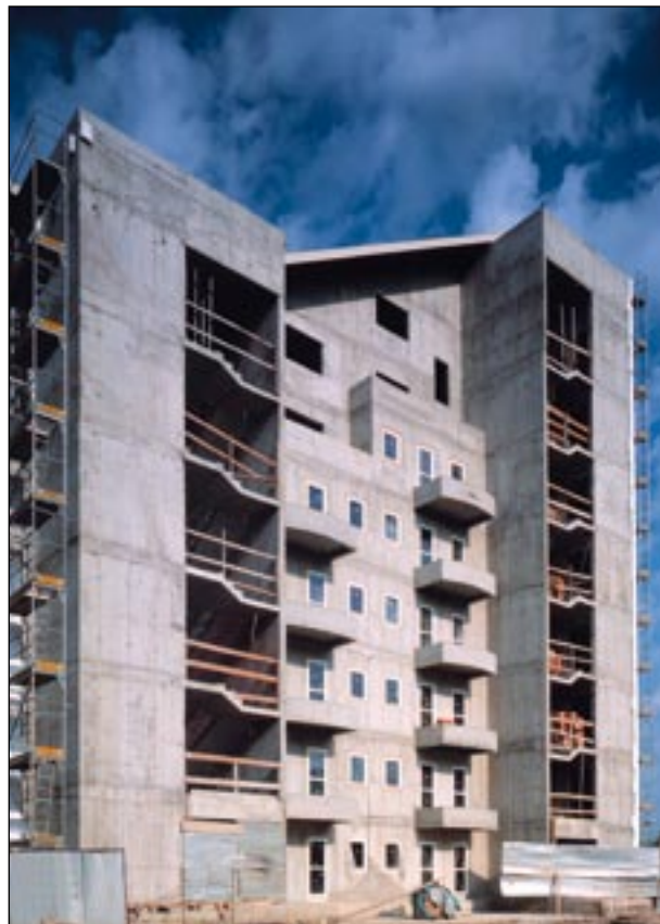
Konstrukcje żelbetowe są w stanie wytrzymać nawet długotrwałe warunki intensywnego pożaru, w których temperatury przez wiele godzin sięgają 1000°C
