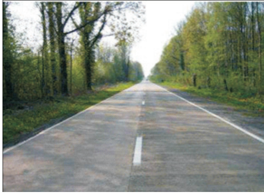
Rys. 5. Droga o nawierzchni betonowej CRCP, czyli z wbudowanym zbrojeniem ciągłym, długość odcinka 1400 m, stopień zbrojenia 0,7%. Droga położona w centralnej Belgii w rejonie Bierwart wybudowana w 1967 r. Fotografia drogi wykonana w 2006 r. [15]
