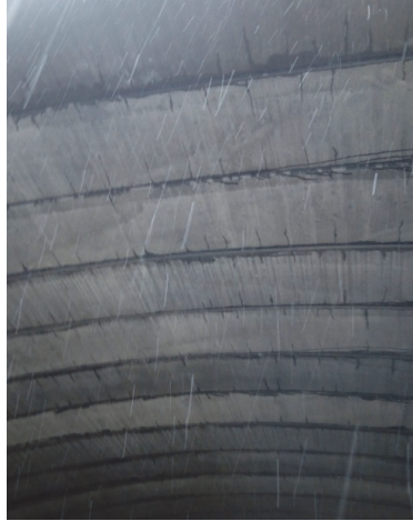
Rys. 2. Zarysowania poszczególnych elementów nośnych przęsła
