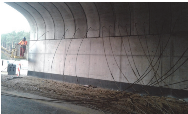
Rys. 1. Zerwane ściąg na wlocie obiektu
