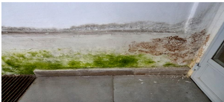
Fot. 1. Przykładowa elewacja z widoczną korożją biologiczną - budynek stołówki do remontu, UZ
