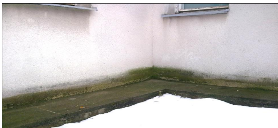
Fot. 2. Załamanie ściany z biokorozją – Hala Sportowa UZ Phot. 2. The collapse of the walls with biocorrosion – Sports Hall of UZ
