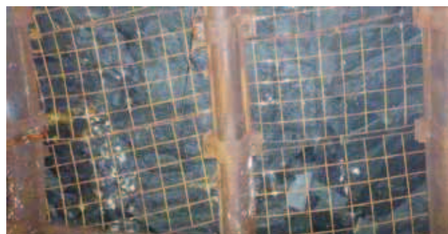
Rys. 4. Niestaranne ułożenie siatek zaczepowych Fig. 4. Negligent lagging sheets arrangement
