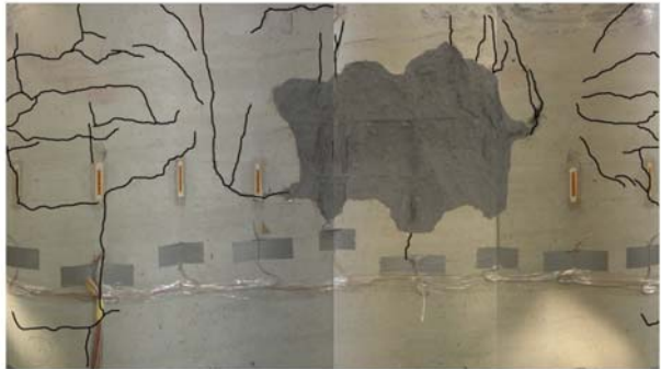
Fot. 18. Zniszczenie słupów w rozwinięciu Photo 18. Column destruction in extension
