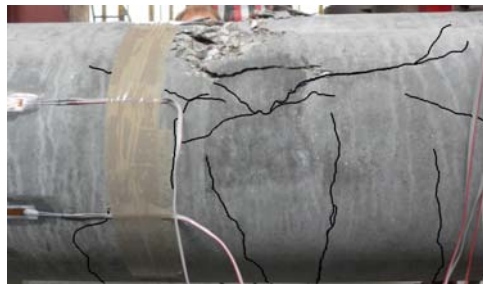
Fot. 13. Zarysowania żerdzi w strefie przy podporowej Photo 13. Cracks of the pole in support area
