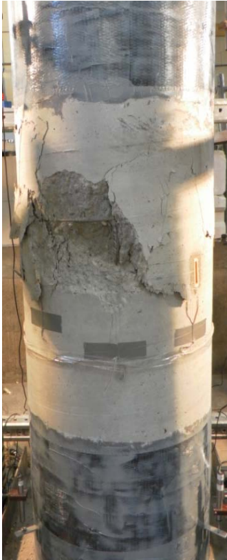
Fot. 17. Typowa forma zniszczenia słupów Photo 17. Typical form of columns destruction
