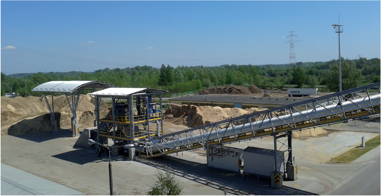
Fot. 6. Elektrownia Połaniec - stacja rozładunku i transportu biomasy leśnej
