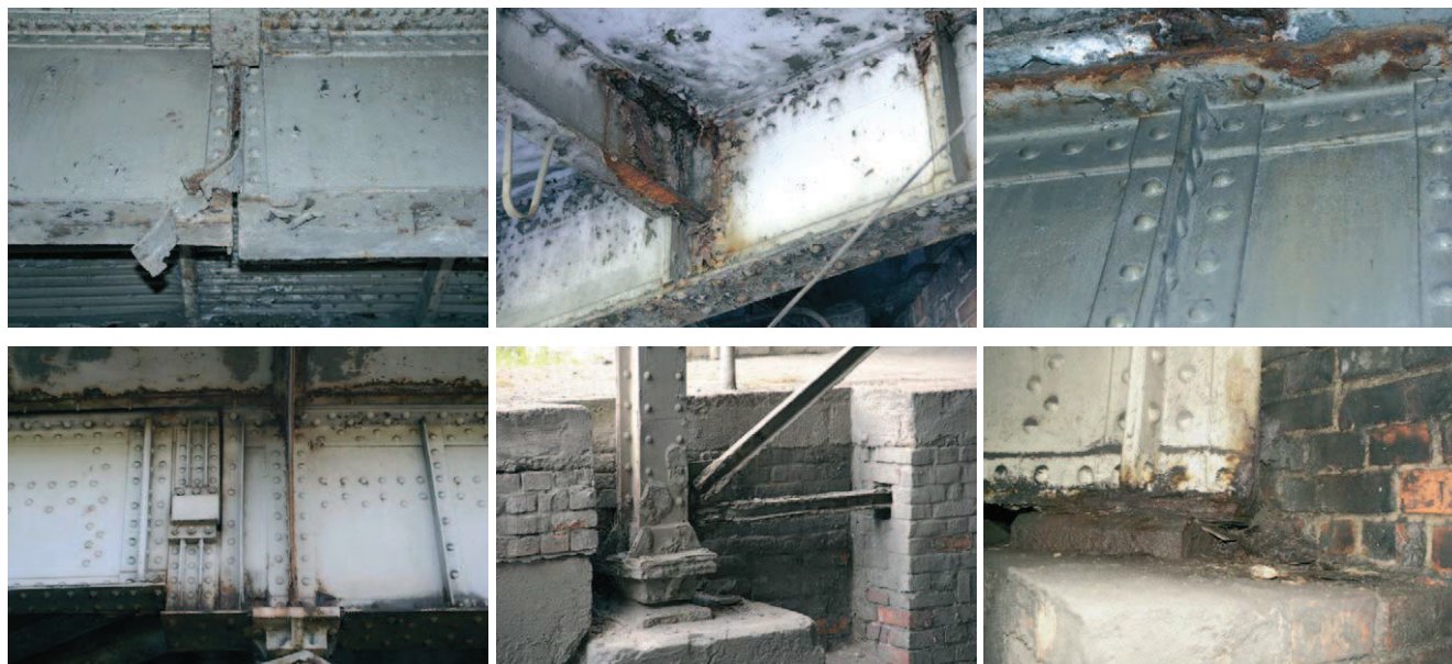
Rys. 3. Uszkodzenia konstrukcji przęseł – mechaniczne uszkodzenia dźwigarów w obrębie przegubu oraz korozja elementów pomostu, dźwigarów głównych oraz podpór
