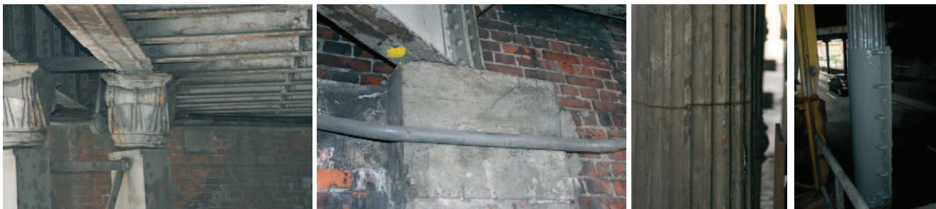
Rys. 4. Uszkodzenia konstrukcji podpór – pęknięcia i deformacje słupów i głowic filarów, pęknięcia ciosu podłożyskowego
