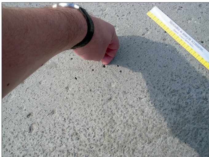
Fot. 18. Porowata powierzchnia nawierzchni betonowej (fot. St. Rewiński)
