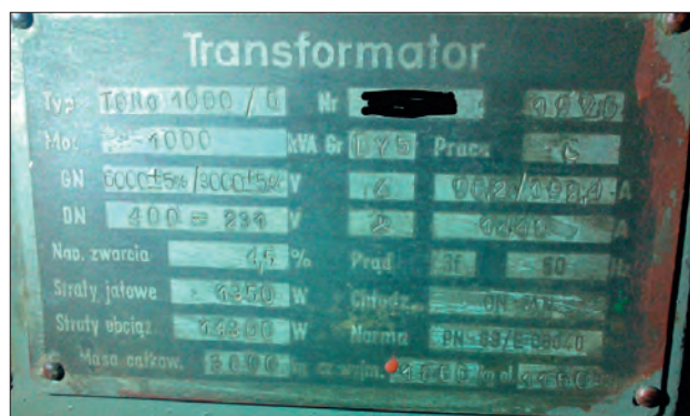
Rys. 1. Tabliczka znamionowa transformatora
