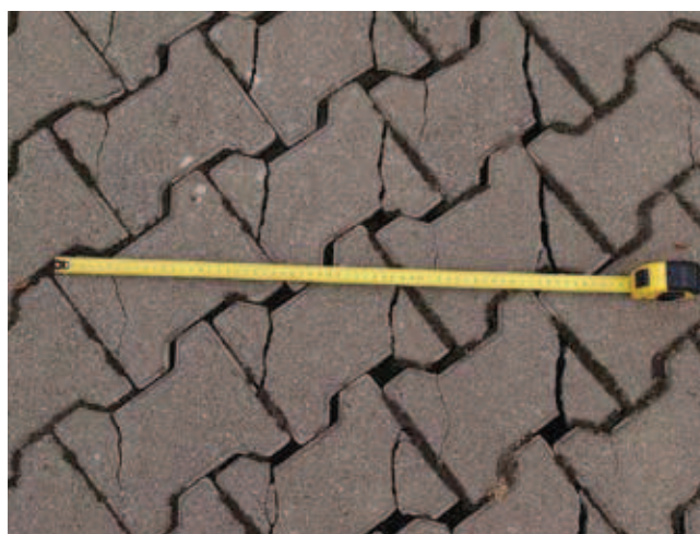
Rys. 5. Uszkodzenia nawierzchni wykonanej z kostki typu Behaton w złożonym stanie odkształceń
