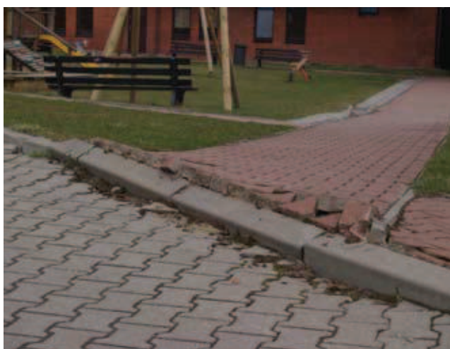
Rys. 9. Uszkodzenia rys. 8a
