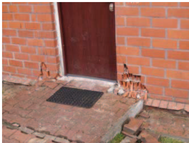
Rys. 11. Uszkodzenie cokołu budynku
