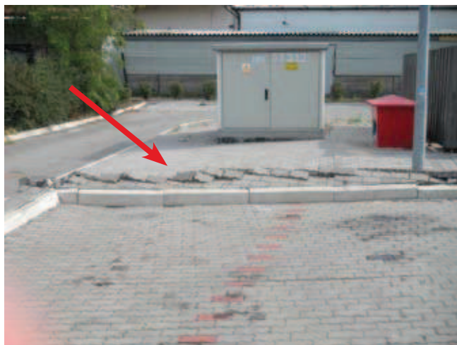
Rys. 2. Uszkodzenie nawierzchni terenu stacji benzynowej
