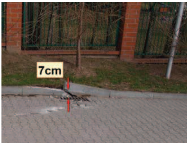
Rys. 7. Nasunięcie i uszkodzenie (zniszczenie) krawężników
