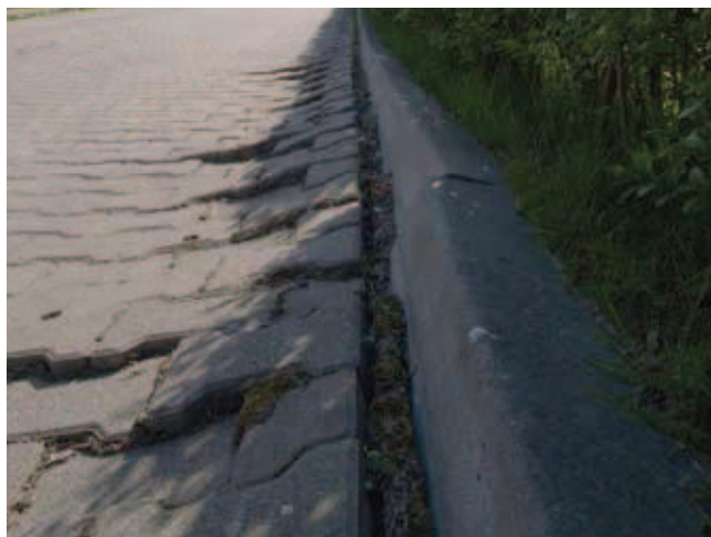
Rys. 10. Uszkodzenia rys. 8b
