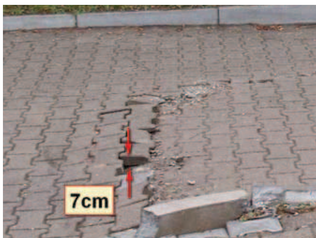
Rys. 4. Poprzeczne i podłużne uszkodzenie nawierzchni drogi
