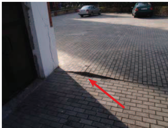
Rys. 3. Wypiętrzenie całej płaszczyzny nawierzchni
