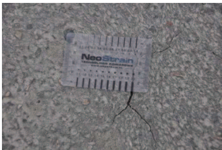
Rys. 6. Obiekt 8; pomiar rozwartości pęknięcia w warstwie wiążącej nawierzchni nad pęcherzem
