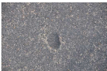
Rys. 10 Obiekt 4; mały pęcherz pod izolacją na podłożu zagruntowanym żywicą epoksydową
