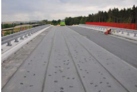
Rys. 4. Obiekt 11; widok pomostu ze śladami zaklejonych punktów przebicia izolacji
