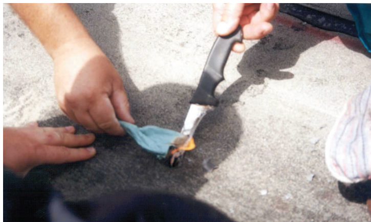
Rys. 12. Obiekt 1. Spalanie gazu wydobywającego się z pęcherza; papier został zapalony od palącego się gazu; asfalt w papie nadtopia się wokół otworu w izolacji
