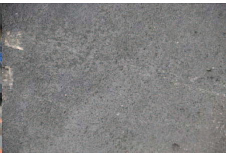
Rys. 9. Obiekt 4; podłoże zgruntowane roztworem asfaltowym po odrywaniu papy przez pęcherz, po zdjęciu nawierzchni i izolacji
