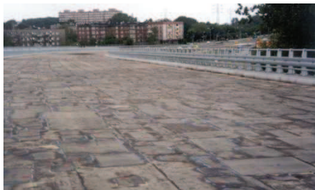
Rys. 2. Obiekt 1; jezdnia z pęcherzami; widok po wykonaniu pierwszej naprawy
