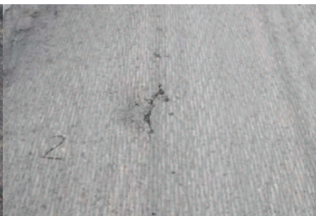
Rys. 7. Obiekt 3; spękana warstwa wiążąca nawierzchni nad pęcherzami pod izolacją
